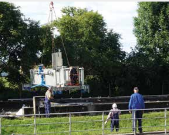
Fotos: Kläranlage Karlsfeld
