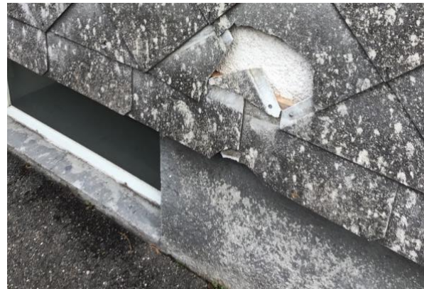
Kaputte Schindeln an der Westfassade des Wohnhauses auf dem Flurstück Nr. 977
