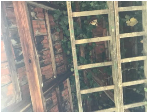
Offenes Dach der Scheune auf Flurstück Nr. 977/2
