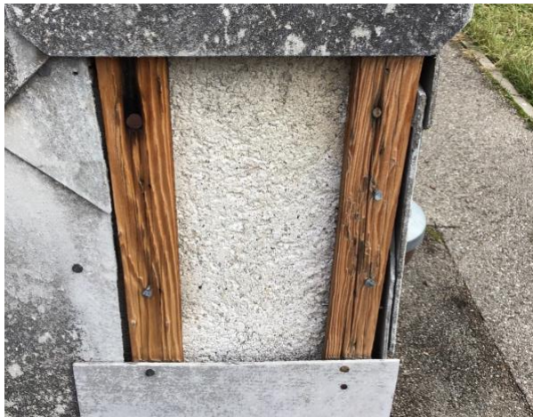
Abbildung 6: fehlende Schindel an Außenfassade, dahinter ca. 3 cm Hohlraum
